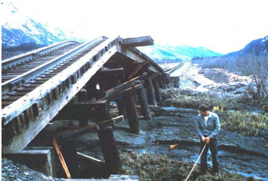
شکل ۴-۱- خرابی پل راه‌آهن واقع بر روی دریاچه‌ی Kenai در طی زلزله‌ی آلاسکا
