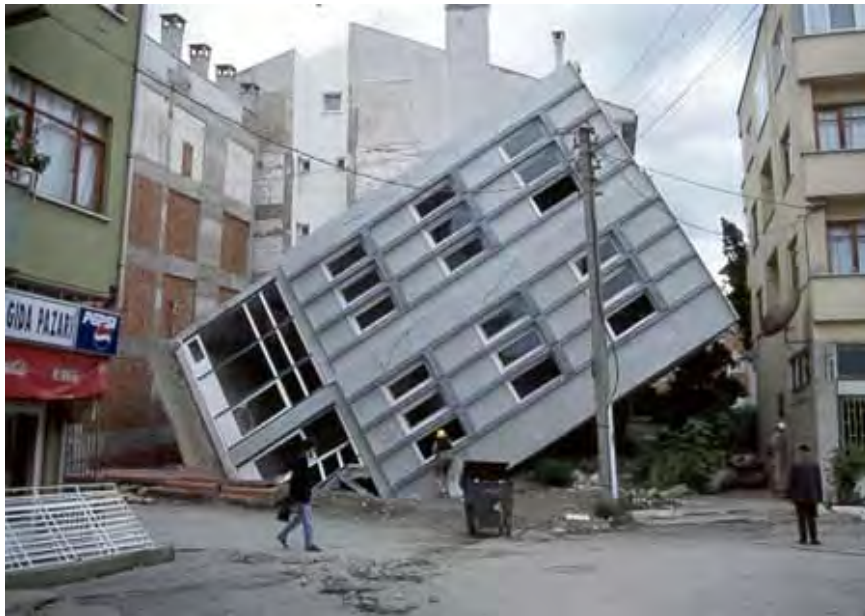
شکل ۱-۱۳- نمونه‌ای از کج‌شدگی و تخریب ساختمان‌ها در شهر Adapazari در زلزله‌ی Kocaeli
