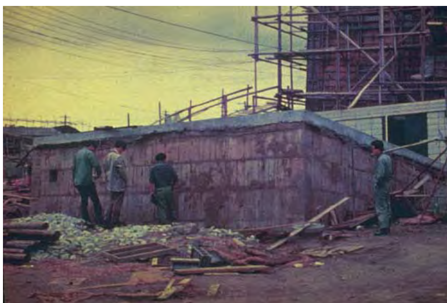
شکل ۲-۱۱- بیرون‌زدگی مخزن بتنی از زمین در اثر روانگرایی خاک اطراف مخزن در زلزله‌ی سال ۱۹۶۴ نیگاتا
