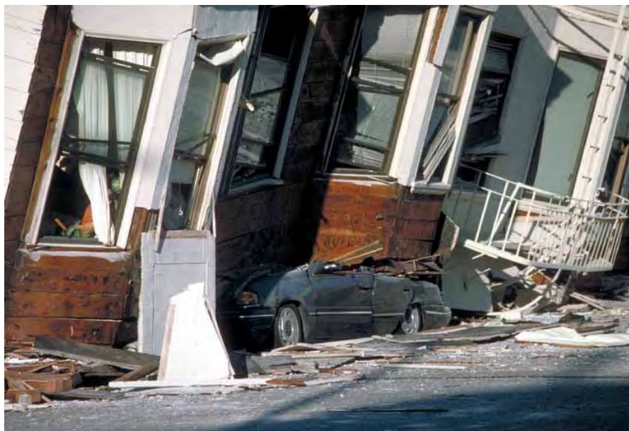
شکل ۱-۱۰- فرورفتن ساختمان در اثر روانگرایی در ناحیه‌ی ساحلی Marina در زلزله‌ی Loma Prieta
